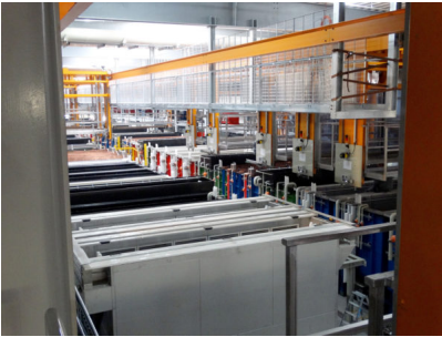
Bildtext 2: Das Volumen der 180 Bäder mit 540 m3 zeigt die Dimension der neuen Galvanikanlage. 50 verschiedene Oberflächen Ausführungen, das heißt sämtliche vom Markt eingesetzte Oberflächenvarianten, optional in Automobilqualität, sind jetzt lieferbar. Foto: Kesseböhmer
